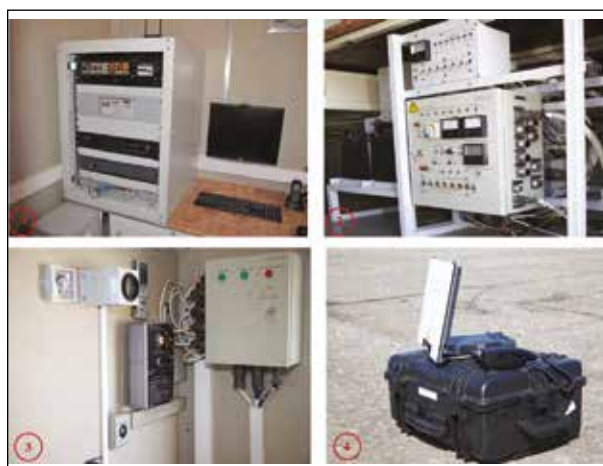
Рисунок 13 — Оснащение модуля МОИ (1 – Автоматизированное рабочее место начальника модуля МОИ. 2 – Блок управления электропотребителями. 3 – Кабельный ввод, пульт управления климатической установкой. 4 – Станция спутниковой связи Инмарсат BGAN Explorer 700)
