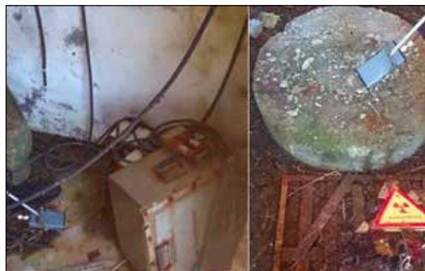
Рисунок 20 — Обследование подвального помещения и демонтированного осветительного оборудования на наличие радиоактивного загрязнения прибором ИМД-2НМ
